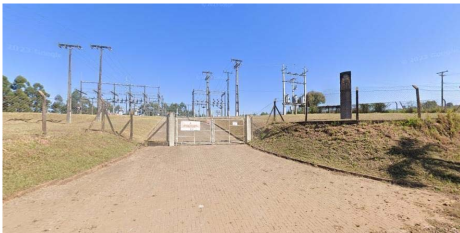
Figura 10 - Subestação da COPEL
